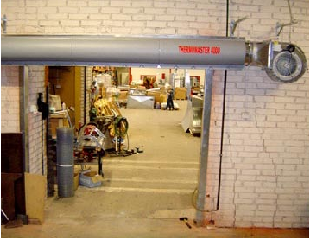
Kuva 2. Thermomaster 4000 ilmaverho asennettuna.
